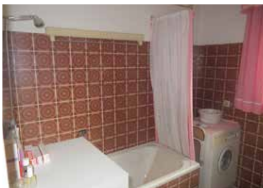
Im Blumengarten 5 und 5a - Badezimmer vor der Sanierung...
